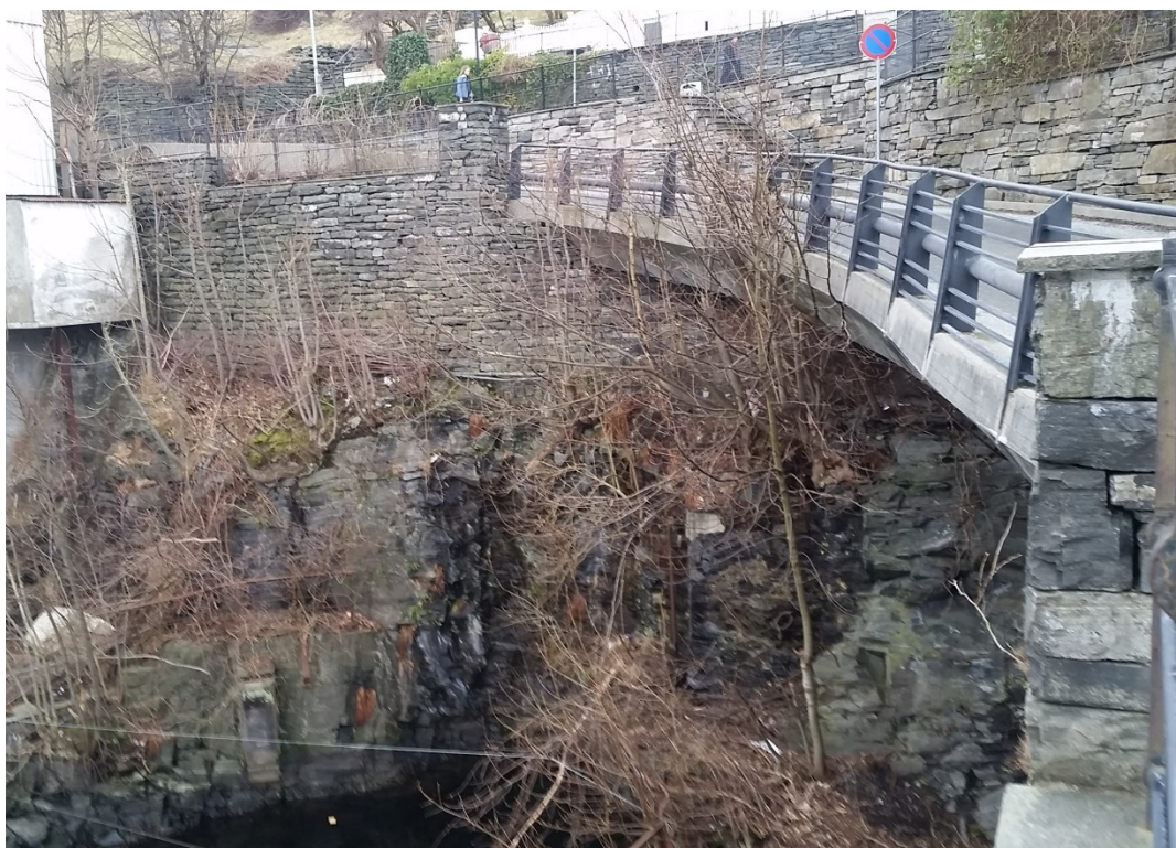
Bildet viser tørrmur og utkragning i dag over dokk. Da bildet er tatt vinterstid ser man klart problemene med en videre utkragning.
